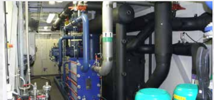
Ratakylmäkoneisto kontissa / Refrigeration container /
