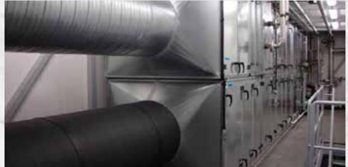
Ilmanvaihtokoneisto / Air conditioning / Вентиляционная установка
