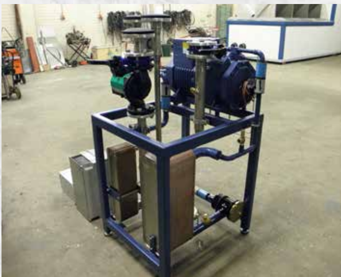
Lämpöpumppu / Heat pump / Тепловой насос
