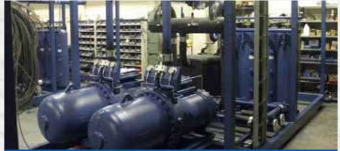
Sochi 7000 IR AC / Холодильная установка ледовой арены на 7000 зрителей в г. Сочи
